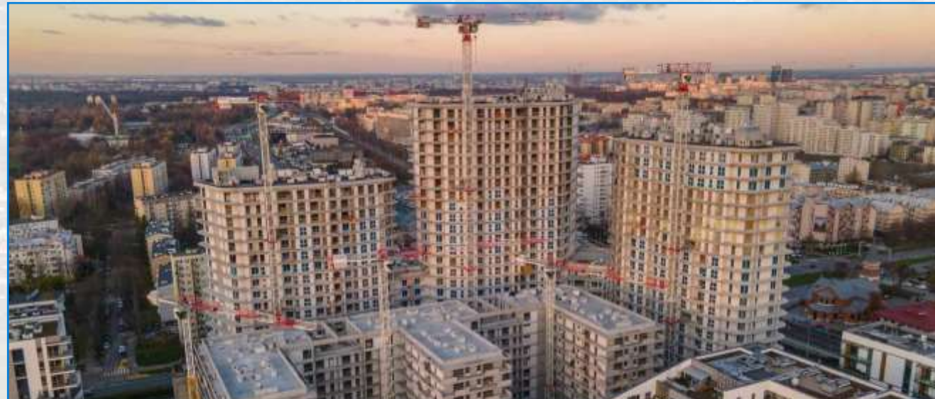
Warszawa – Bliska Wola Tower – ze względu na specyficzną zabudowę (bliskie sąsiedztwo wysokich budynków), zwane jest “warszawskim Hong Kongiem”
